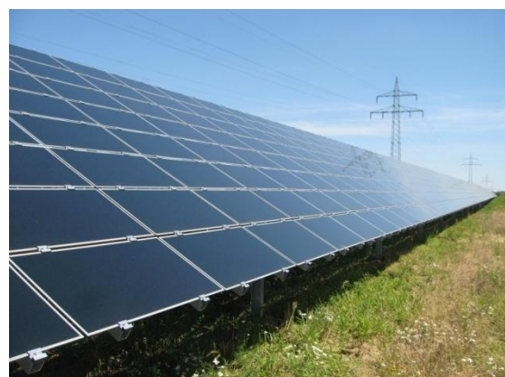
Abbildung 1 Neue Anforderungen für den Anschluss von PV-Anlagen an das Niederspannungsnetz
